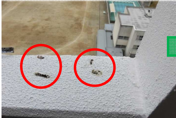
固定具設置箇所の汚れ(フンなど)
